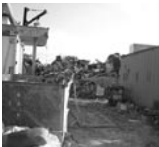
廃棄物放置現場
