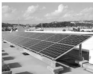
町立図書館太陽光パネル
