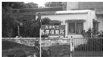
老朽化が進んだ西原保育所
