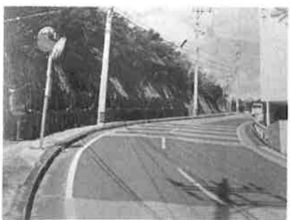
被災した道路擁壁(呉屋地内)
