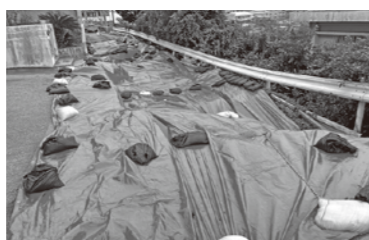
陥没した町道棚原1号線
