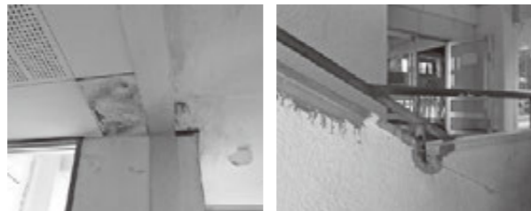
西原東小学校校舎の剥離や漏水による傷み
