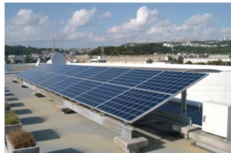
事務室の照明電源として利用 (発電容量3.4kW)
